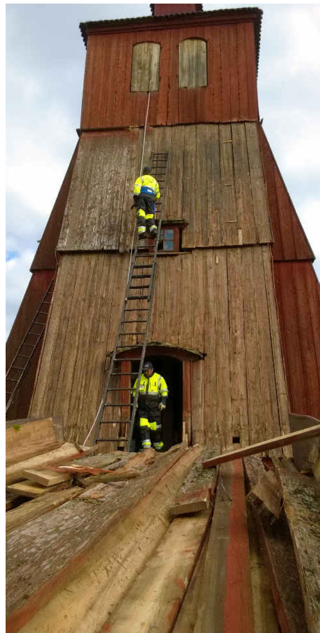
1700-luvulla rakennetun kelloapulinkaton kunnostus jatkui kesällä, kun ulkovouri laitettiin uusiksi. Tapuli sijaitsee Pyhän Marian kirkon lähellä.
